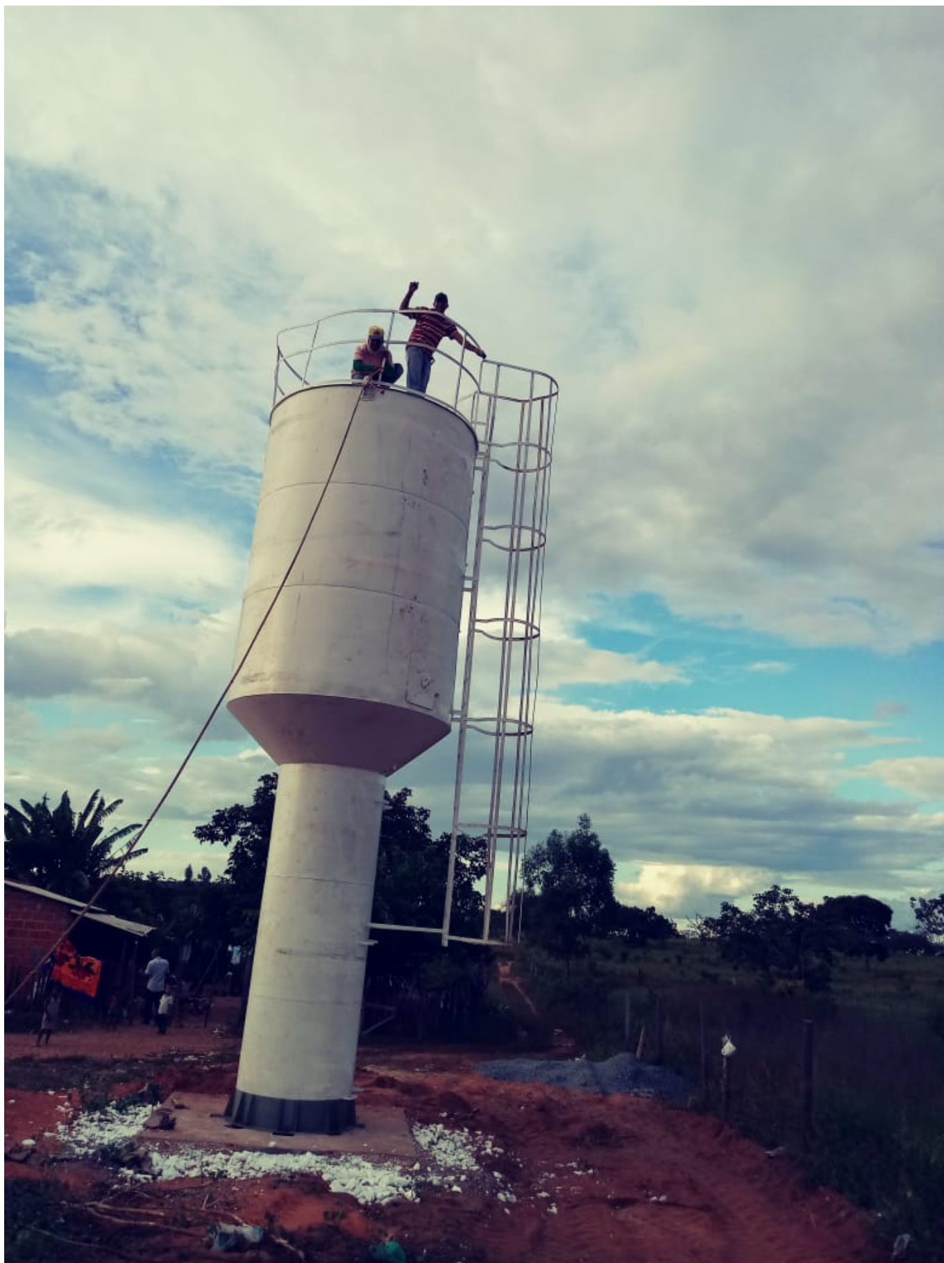
Reservatório de 20 mil litros foi instalado na Comunidade de Muquém (Mirabela, Norte de Minas) complementa o sistema de abastecimento para 800 famílias.
